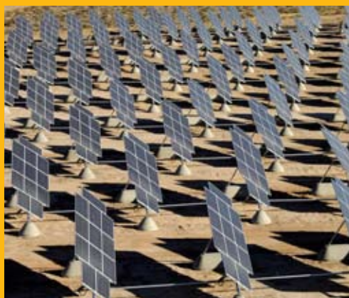
Base aérienne militaire de Nellis - 14 MW - Nevada (États-Unis)
